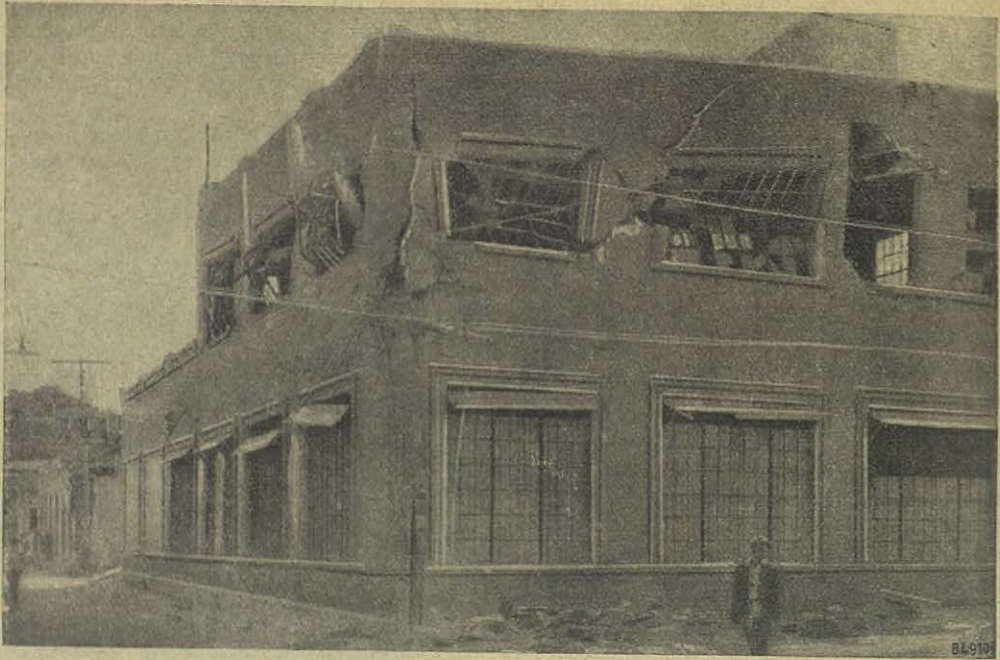
Santiago de Cuba. — Estado del edificio de la Sociedad Swift Cia , después del terremoto.
