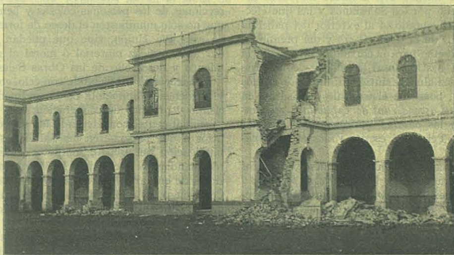
Méjico - Tramo Oeste del Colegio Salesiano después del terremoto.
